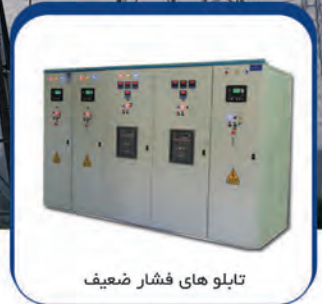
تابلو های فشار ضعیف کشویی
