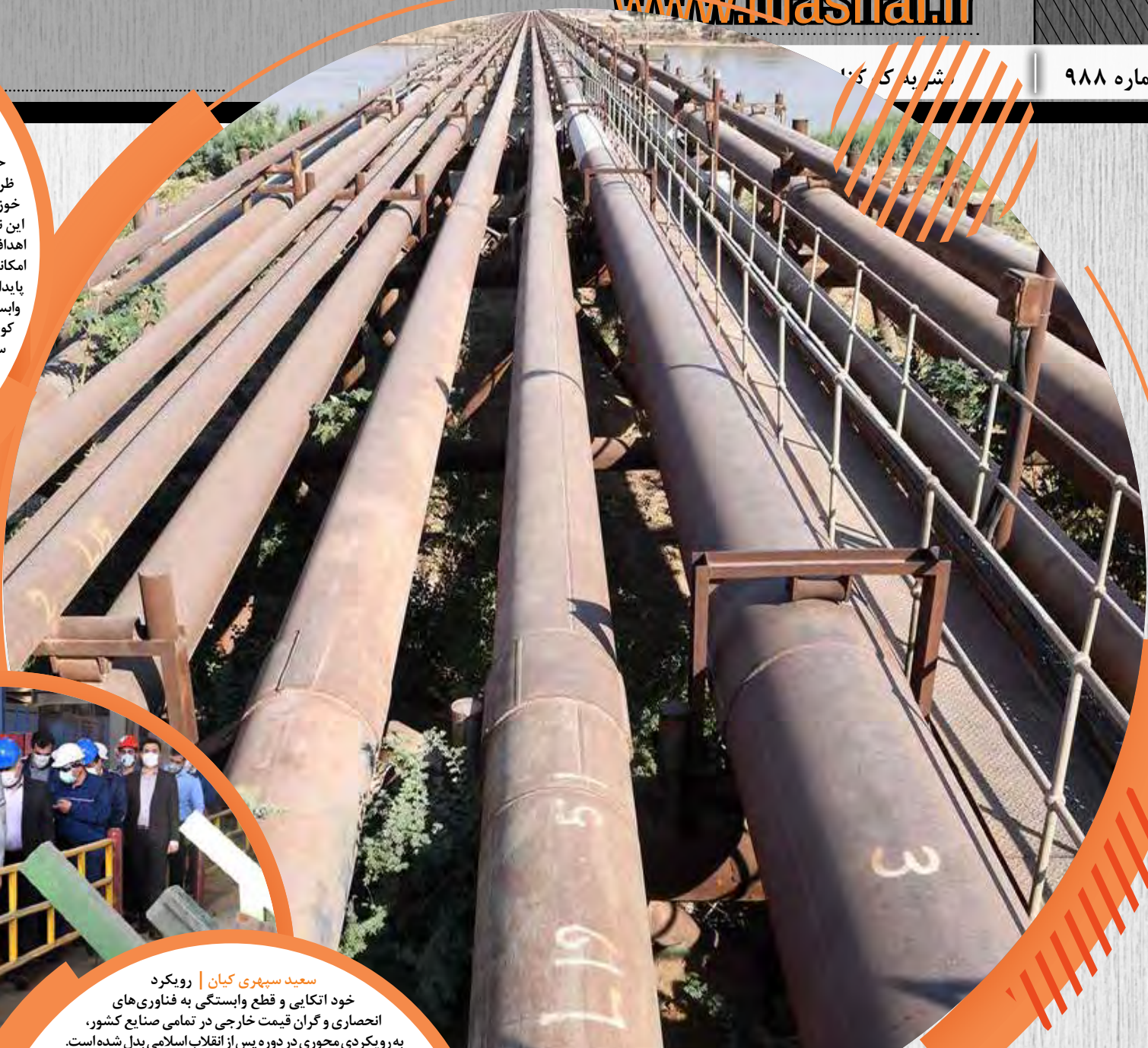
نگاهی به پرونده بومی سازی لوله های بدون درز شرکت ملی مناطق نفت خیز جنوب
