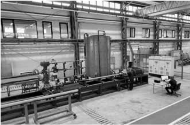
شکل ۶. واحد آزمایش و کنترل کیفی پمپ و گزارش نهایی عملکرد پمپ
