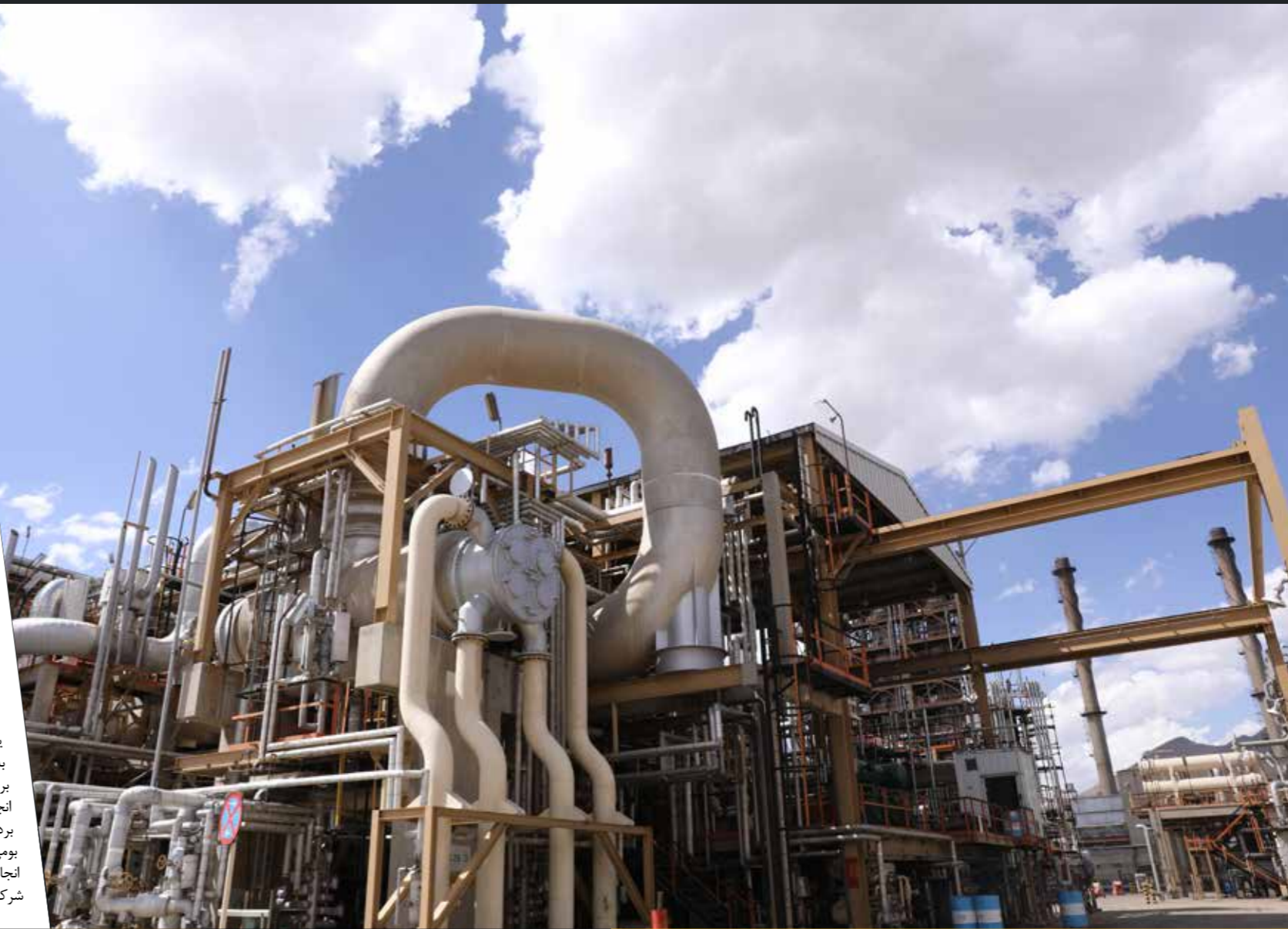
گزارش «مشعل» از واحد تصفیه هیدروژنی باقیمانده سنگین نفت خام پالایشگاه امام خمینی (ره) سازند
